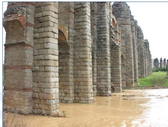
Pilares y contrafuertes reforzados con sillares para resistir las crecidas del Albarregas.
